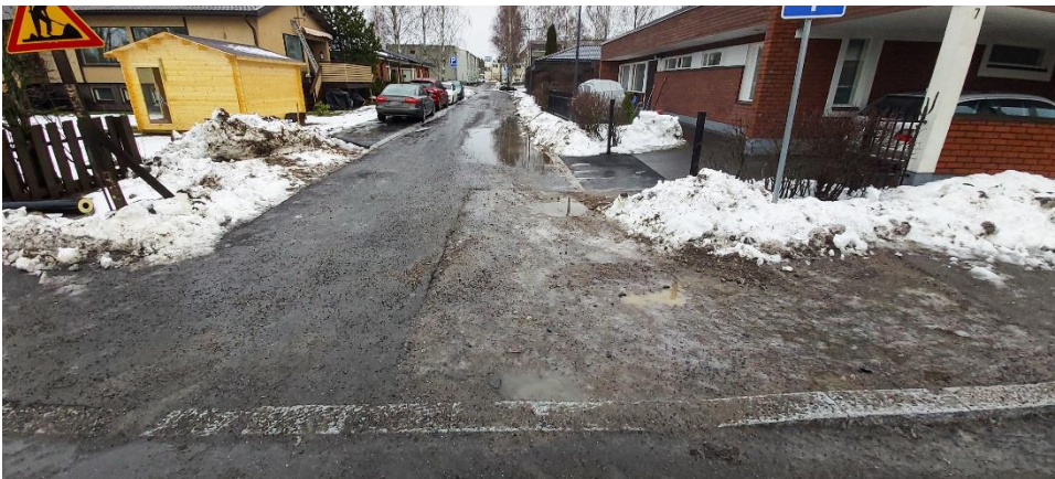
Kuva 11 Kisapolku 30.1.2023. Lumenaurauksien jälkeen sora on levinnyt pitkin katuja ja asfaltoimaton kohta syventynyt.
